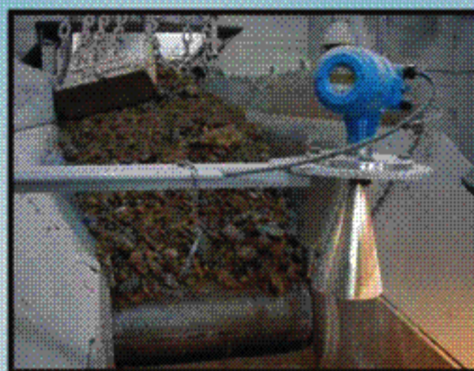
Meranie výšky hladiny v zásobníkoch s kamenivom, KROHNE BM 70A, výška 8 m
